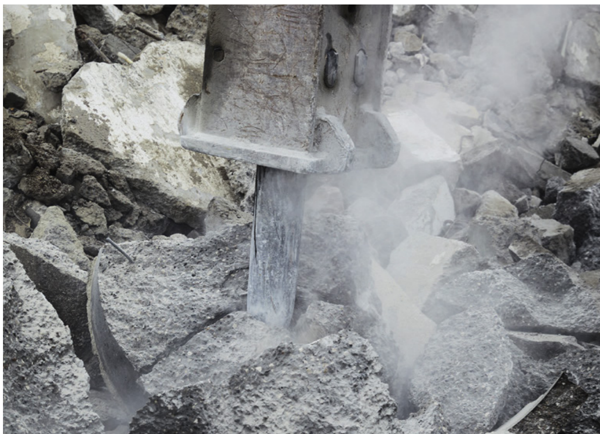
Nedbrydning af beton.
